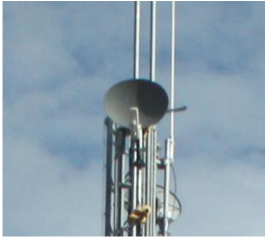
図 3.2 テレスコープアレイ実験では、長距離無線ネットワークの構築に Motorola 社の Canopy PMP 100 を使用している。各タワーに複数の Canopy が設置されているが、周波数を変え Canopy 間の間隔を広げることで干渉を防ぐようにしている。
