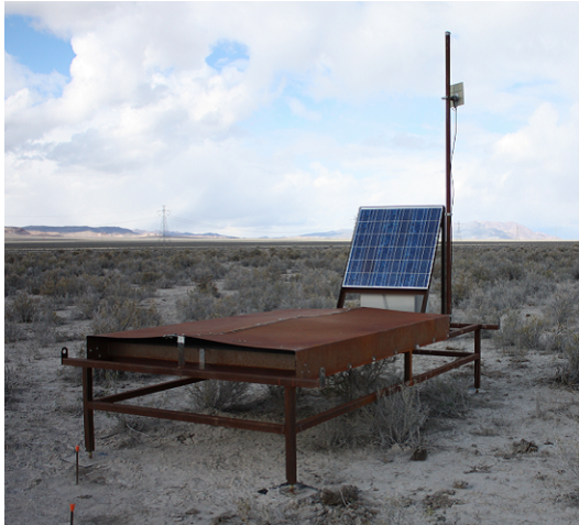
図 3.4 サイトに設置された SD の概観
