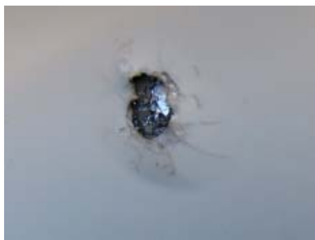
図 3-2-5 破損パネル(拡大)
