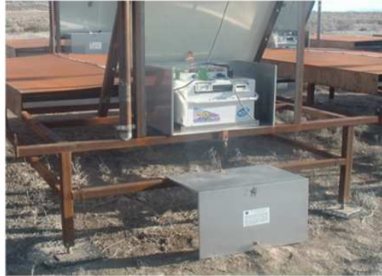
図 2.7: ソーラーパネルの下の箱にエレクトロニクスとバッテリーが収納されている。
